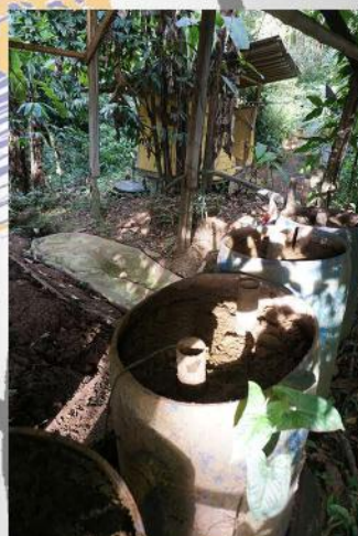
Biodigester à fumier de vache
