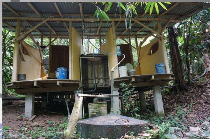
Toilettes reliées à un biodigester (en 1er plan)
